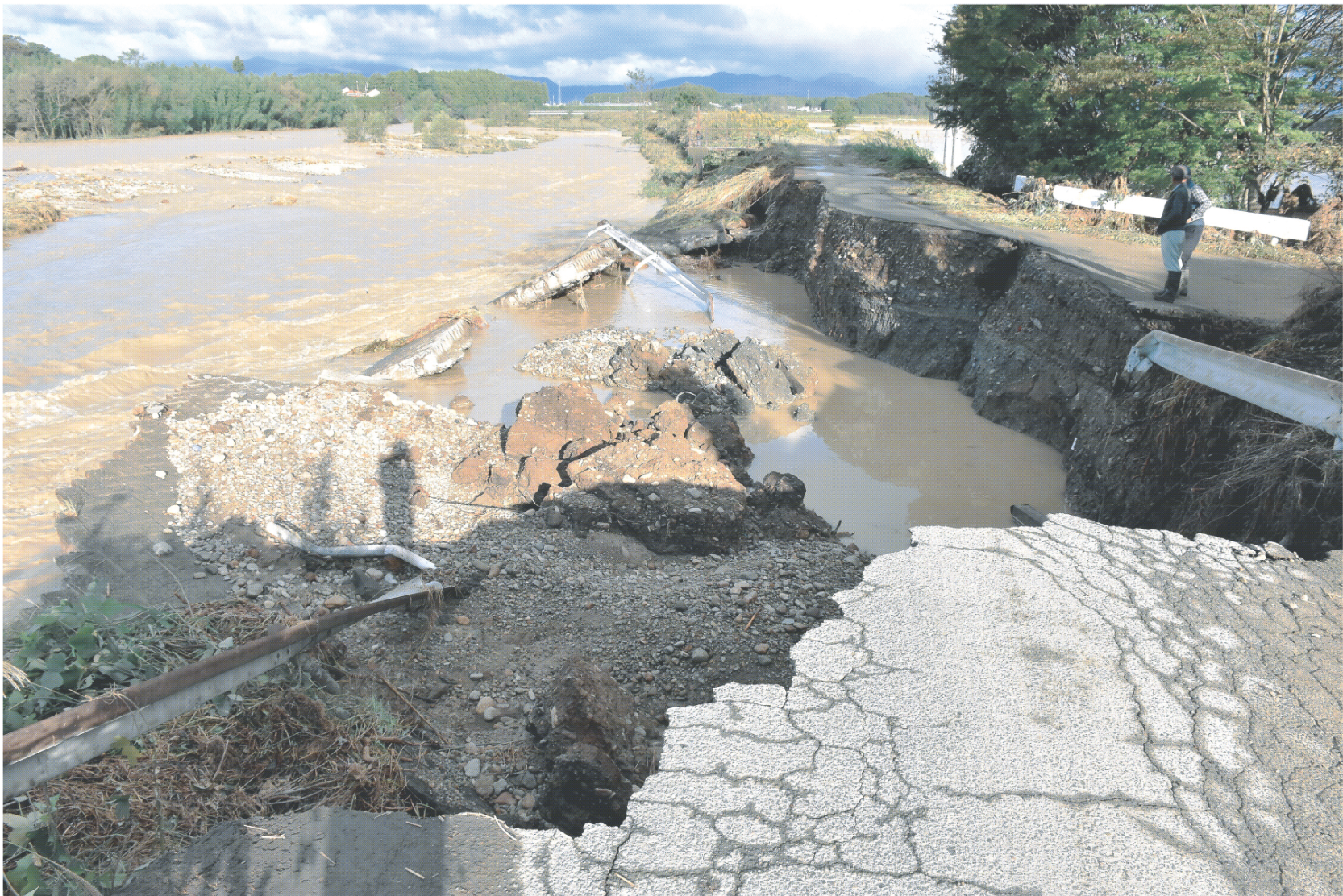
蛇尾川の堤防決壊地点の下流では左岸の側道がえぐられた＝13日午前7時20分、大田原市宇田川
