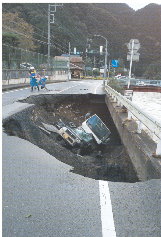
陥没した道路に転落した軽乗用車とトラック。13日午前8時すぎ、鹿沼市草久(読者提供)
